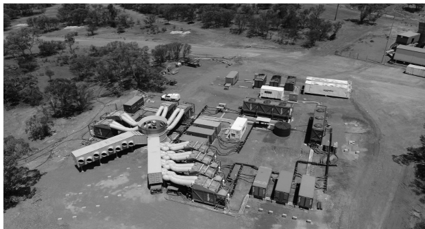
Hình 4. Hệ thống làm mát trung tâm trên mặt đất Aggreko tại mỏ Cobar (Australia)
