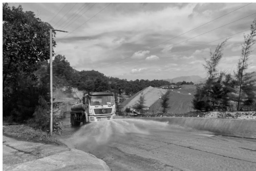
Hệ thống phun nước và xe tưới nước dập bụi các tuyến đường vận chuyển khu vực cảng Làng Khánh
