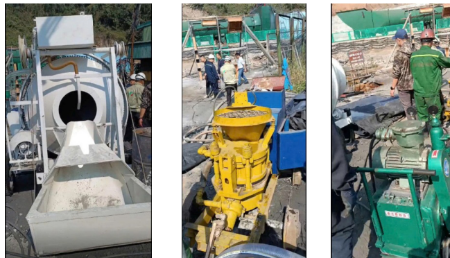
b) Dây chuyền thiết bị thi công lắp đặt trên mặt bằng
