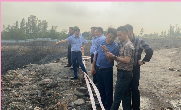
Đoàn kiểm tra theo dõi quá trình thi công thử nghiệm tại hiện trường
