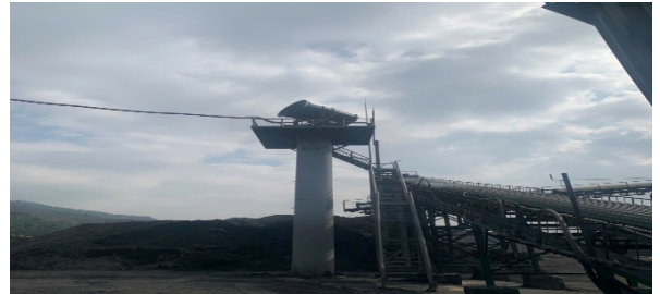
b) Hệ thống phun sương cao áp tại kho than Công ty than Ưng Bí
