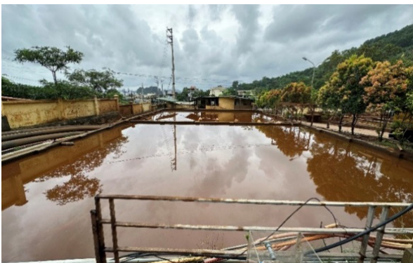
Hình 5. Trạm xử lý nước thải mỏ khu +25 Núi Nhện
